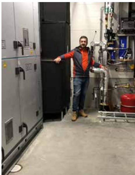
FJERNVARME: Varehussjef og daglig leder Torbjørn Gruben på plass i kontrollrommet der fjernvarmen kommer inn i bygget. Foto: Byggtorget
